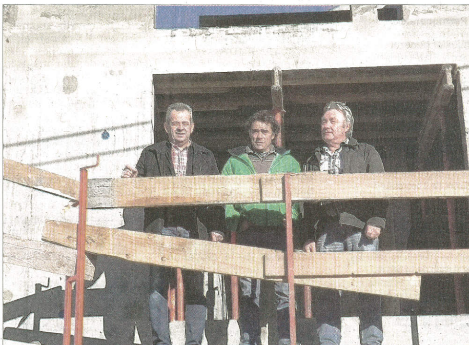
Visite de chantier pour la fin de réalisation du gros œuvre, avec Patrick Gohel, maire délégué de Nâves, Jean-François Rochaix, maire de La Léchère et André Pointet, président de la CCVA.
