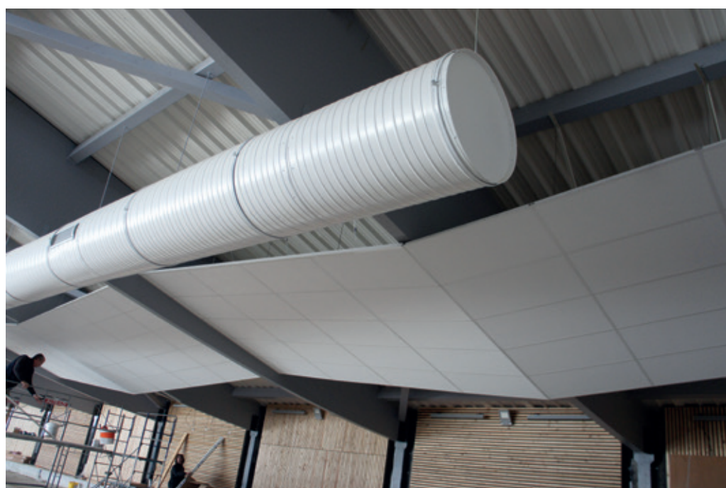
Les travaux entrepris permettront de gagner 44 % sur la performance de l'isolation de l'enveloppe des bassins couverts, plus de 20 % sur la toiture des vestiaires et 60 % sur celle des locaux administratifs et du snack-restaurant.
