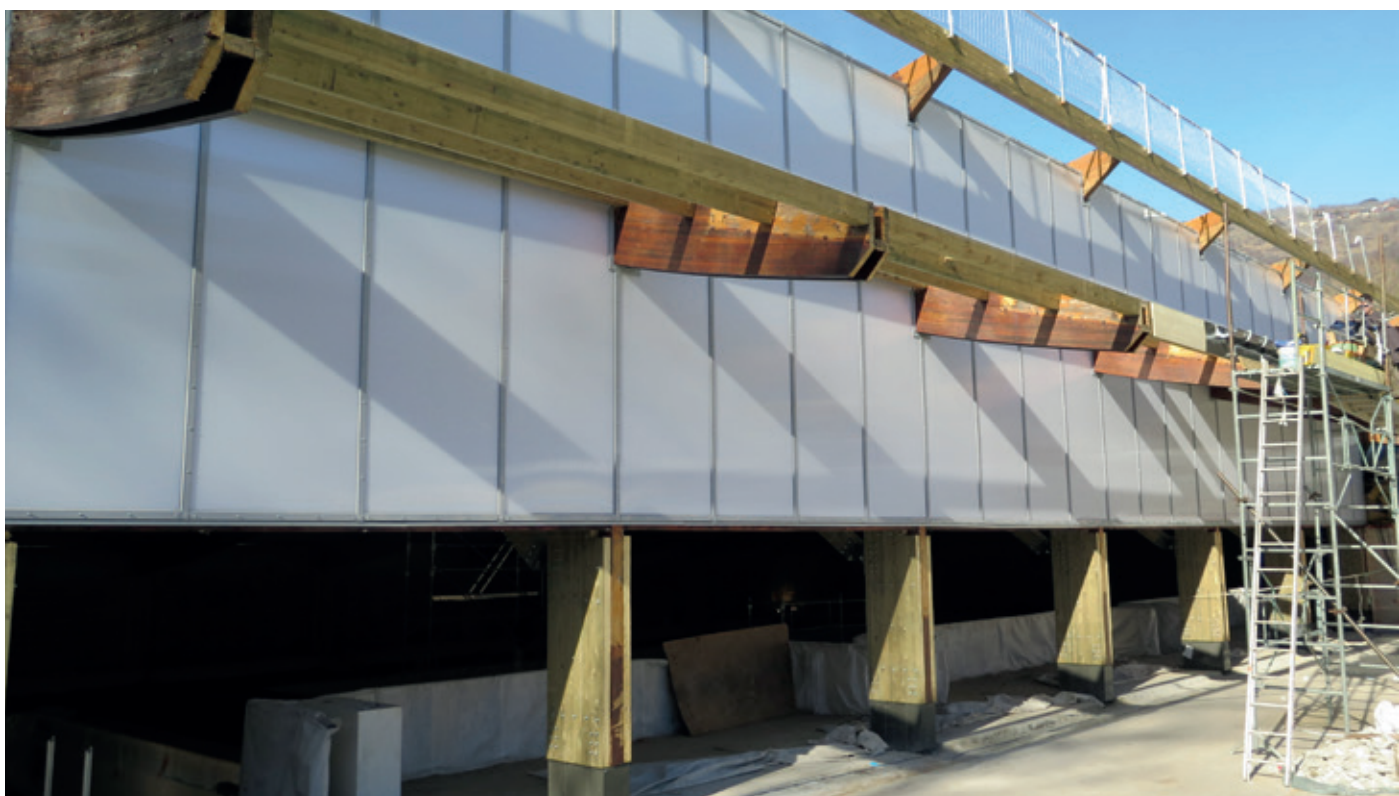
Les différents diagnostics réalisés préconisaient de remplacer ou renforcer tous les équipements structurants d'origine pour moderniser le bâtiment et répondre aux nouvelles exigences réglementaires en la matière.
